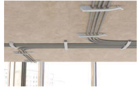
Befestigung von Kabelsträngen
